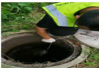
文鑫纺织有限公司雨水排放口
