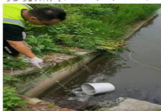
纺印四路四清渠雨水排放口
