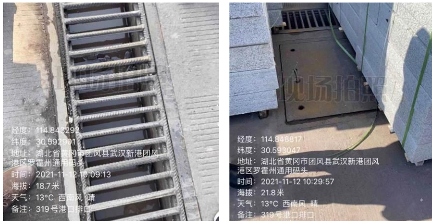
码头雨污水管道和污水沉淀池
