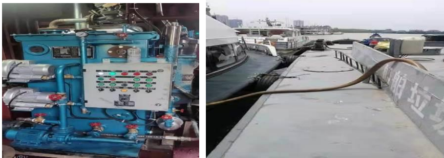
污水预处理设施和污水收集转运
