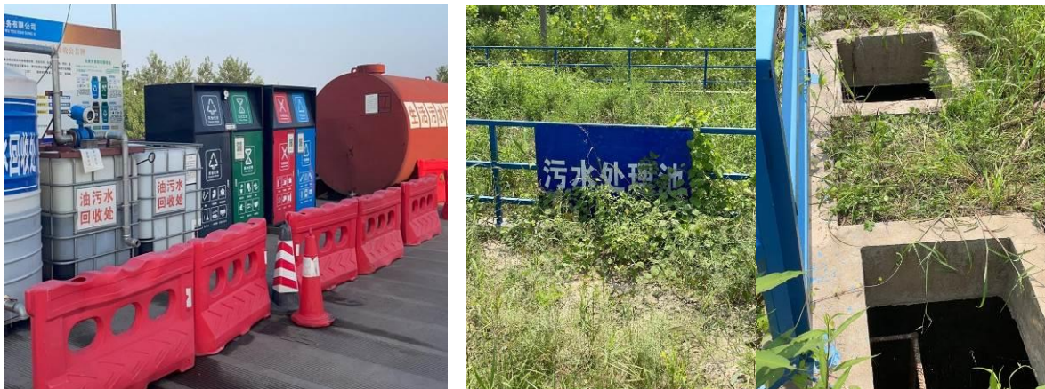
油污水及生活污水回收处及散货污水处理池
